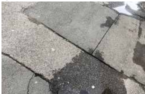
Vsakokratno razkopavanje pusti na cestah poškodbe
