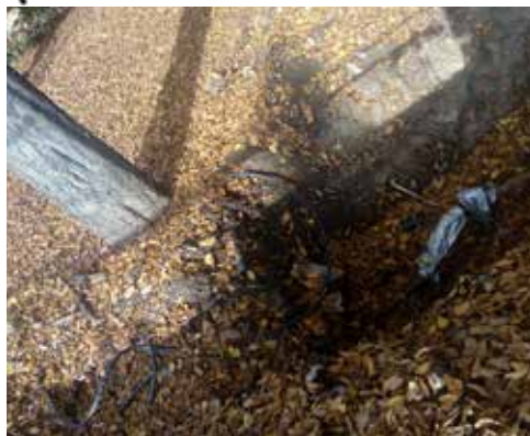
Nestrokovni posegi med gradnjo ogrožajo obstoječe drevje
